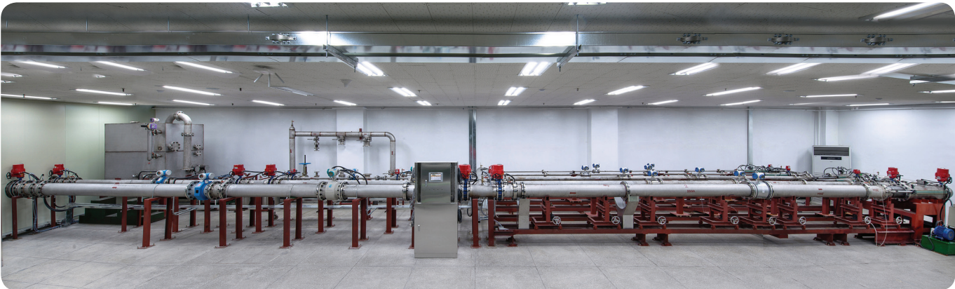
• 액체식 유량실험시설 전경
